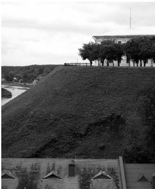
Формирующиеся оползни горы Нового замка. 17 августа 2012 г.
